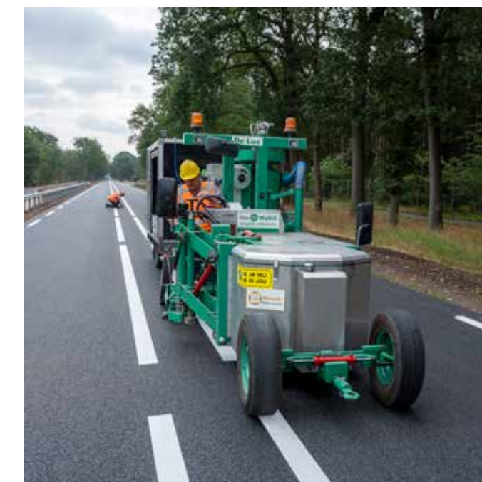
Een speciale machine van Van Wylick zorgt voor hoge productie bij het nauwkeurig plaatsen van de LUX glasbolreflectoren, hier ingezet op de Rijksweg N35
